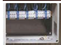
Espacio para conexiones
